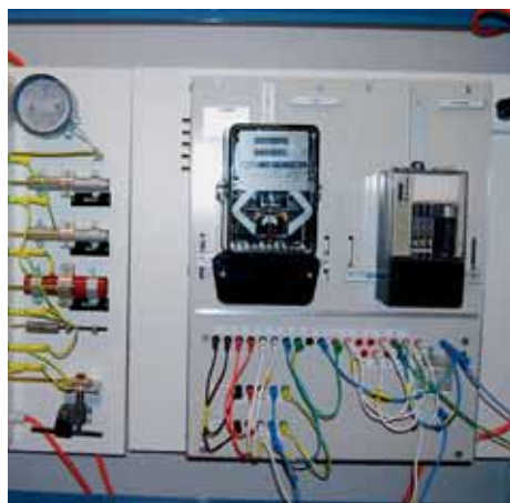
Schaltanlage für Ausbildungszwecke.
